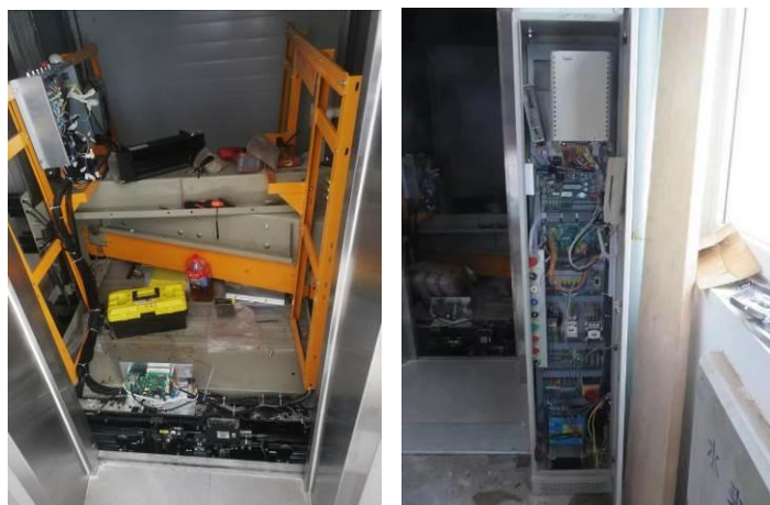
图2 电梯轿厢顶部及控制柜全貌
