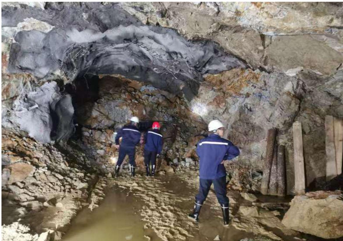
4008 采场西出矿巷道事故点现场情况
