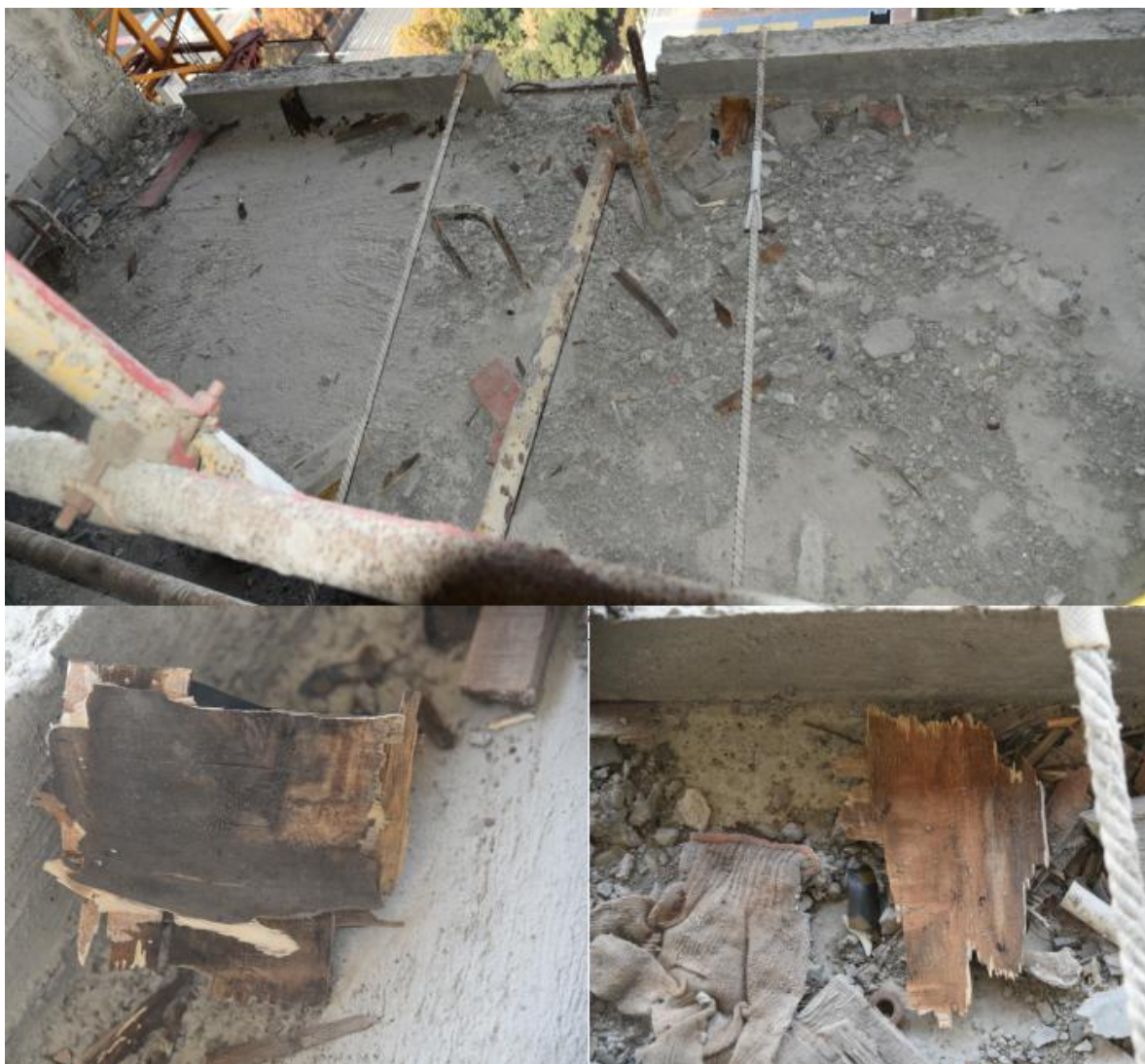
图 5 洞口正下方 21 层地面掉落的破碎的竹胶板
