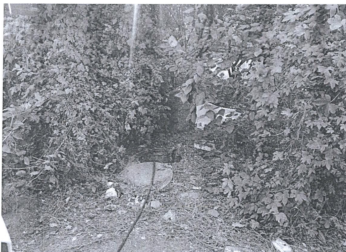
图 2. 涉事污水检查井
