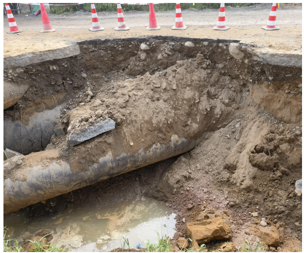
图二：坍塌位置
