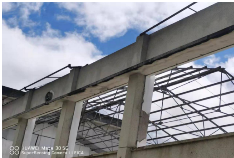
切割位置及墙体预埋件脱落（图六）
