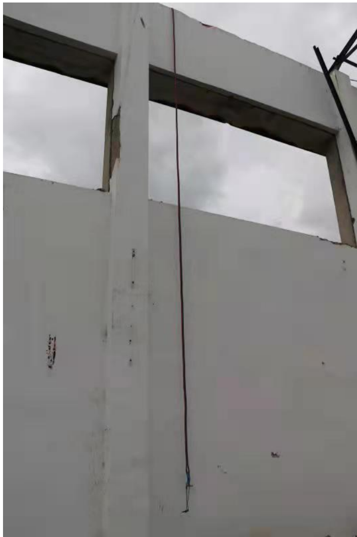
切割位置及墙体预埋件脱落（图七）
