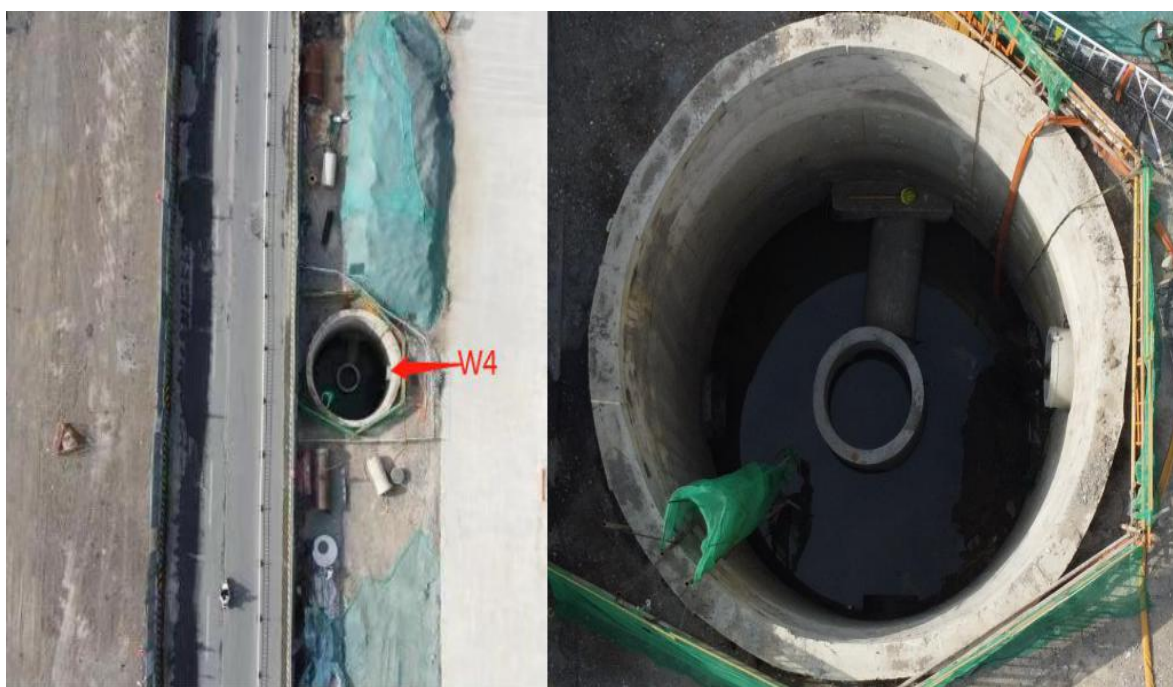
图 3. 事故现场航拍图
