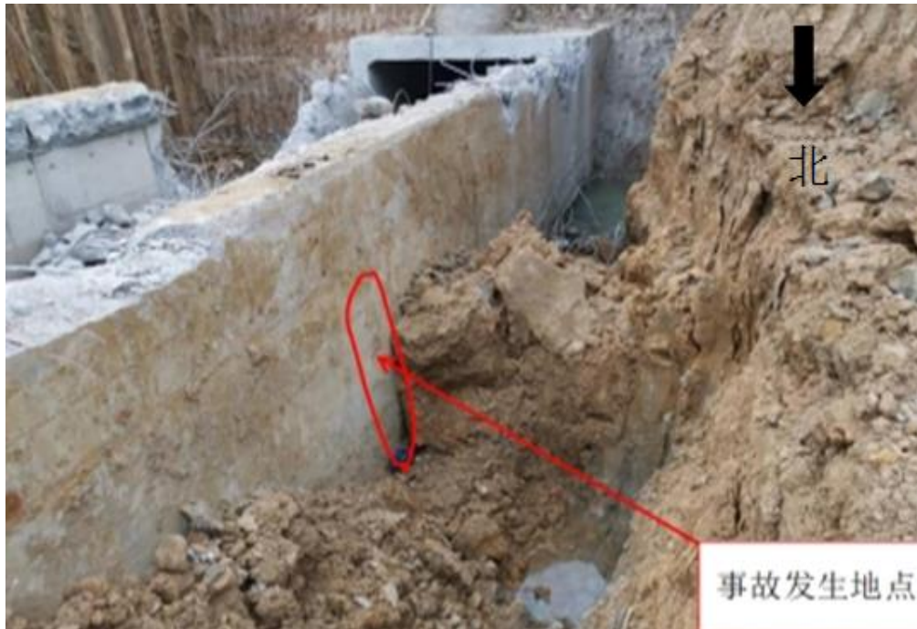
图 4 事故沟槽现场
