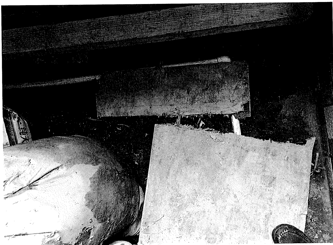
图7 四楼阳台现场断裂的旧模板
