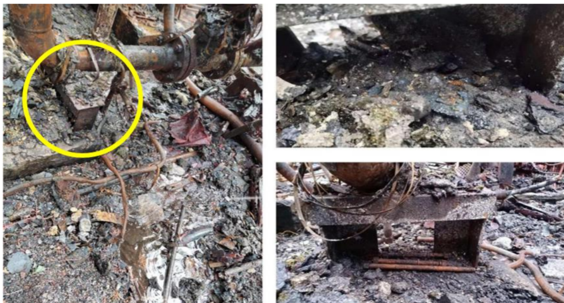
图 3-6 在 P-8000S 泵出口管道支座内发现的 3 根螺栓
