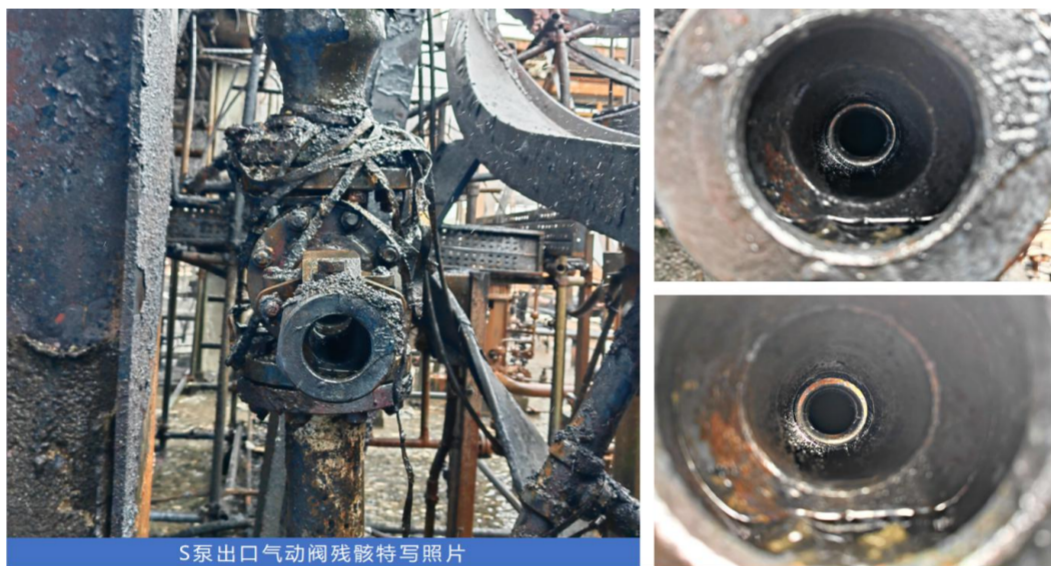
图 3-4 P-8000S 泵出口气动阀残骸照片
