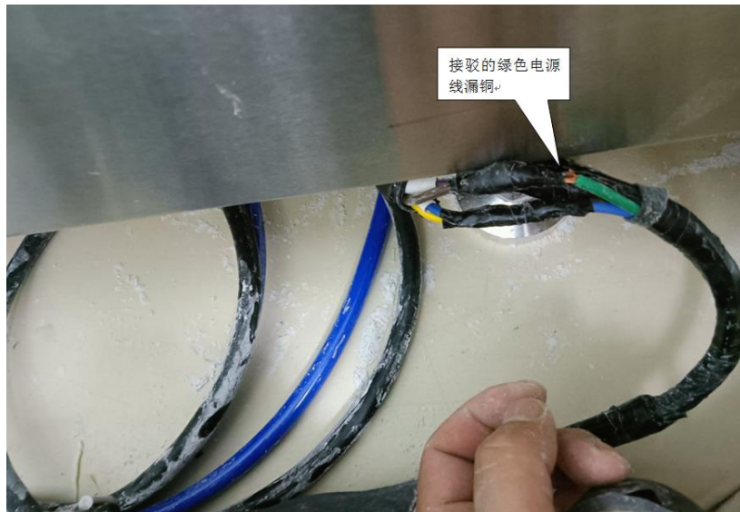
图8 王晖提供绿色电源线漏铜照片
