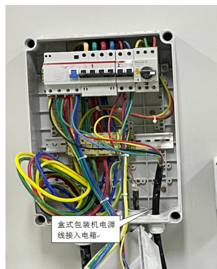
图 7 电源线接入开关箱情况
