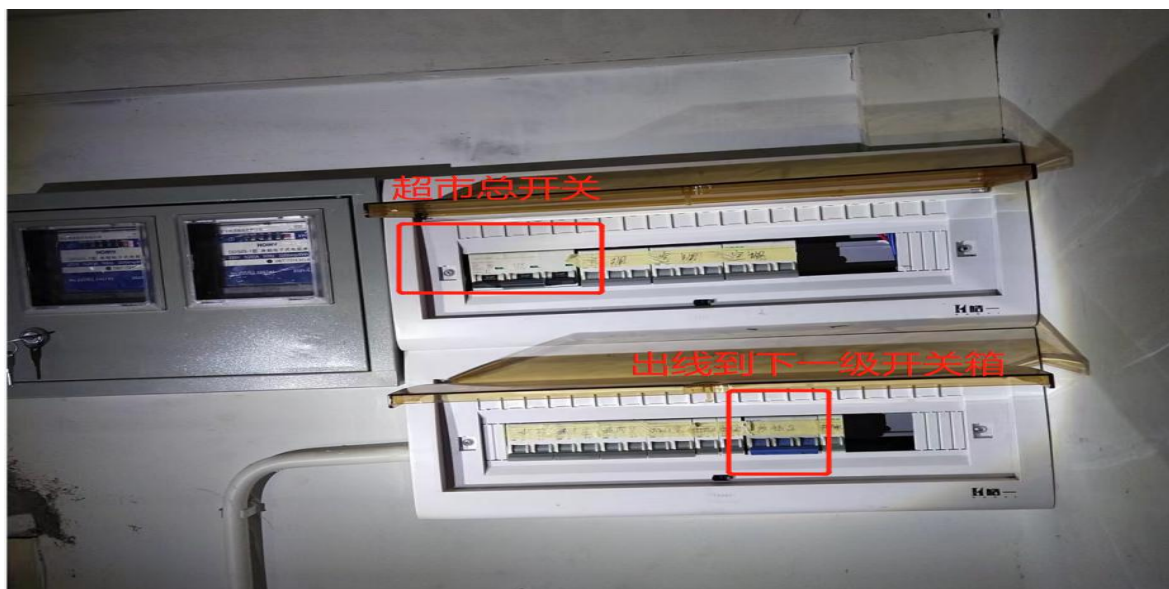
图 8 超市里间房内配电箱
