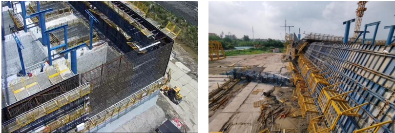
图8 西侧模板坍塌前后对比图
