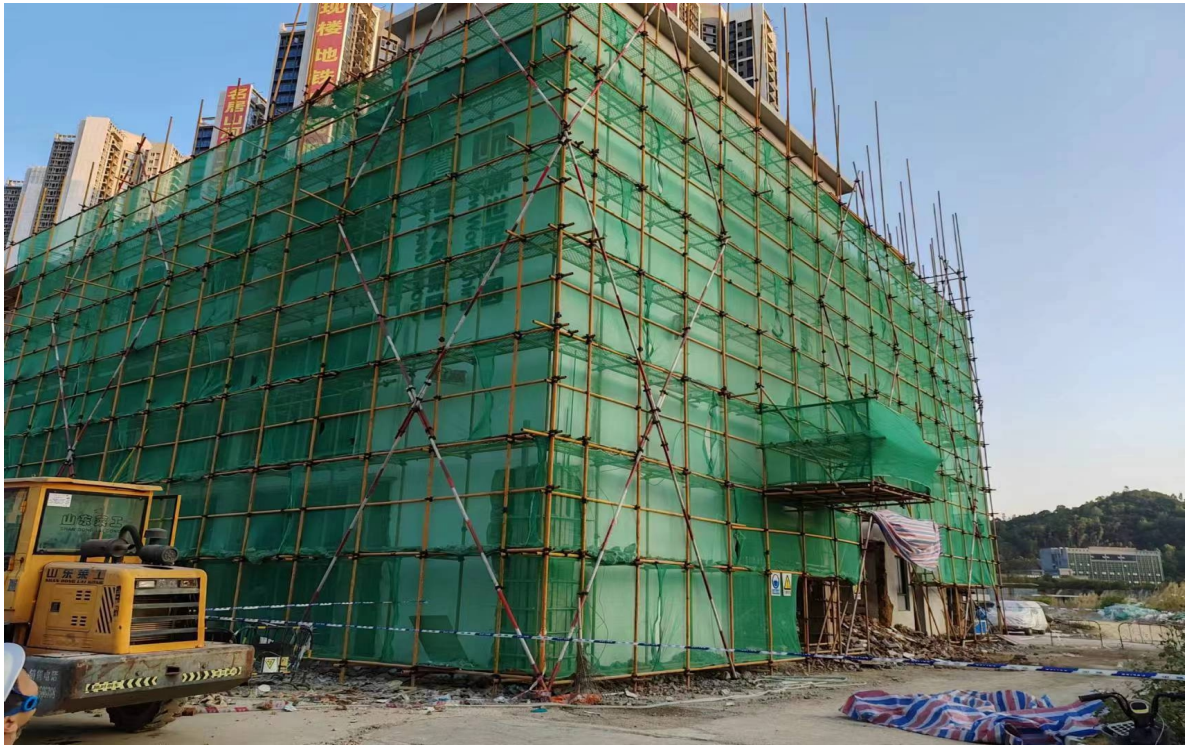
事故现场照片
