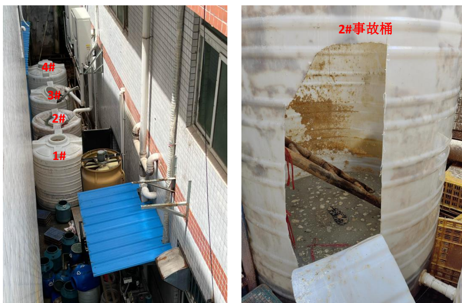
图6 现场废水桶情况
