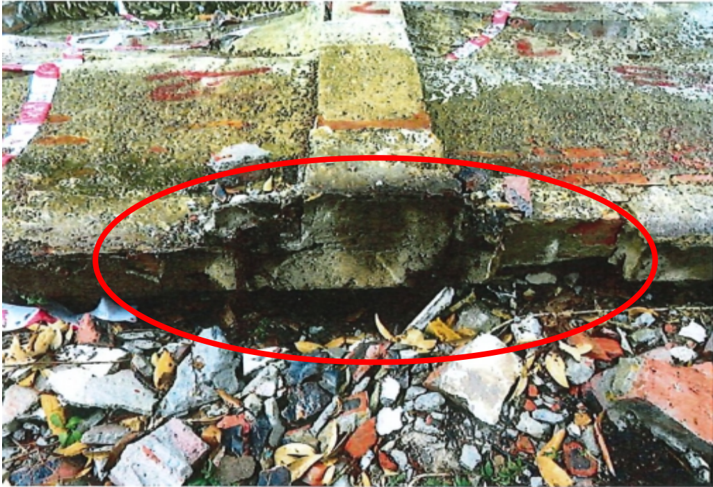
图 4：围墙无独立基础，直接砌筑于厂区原旧水泥地面，底部墙身没有有效埋深
