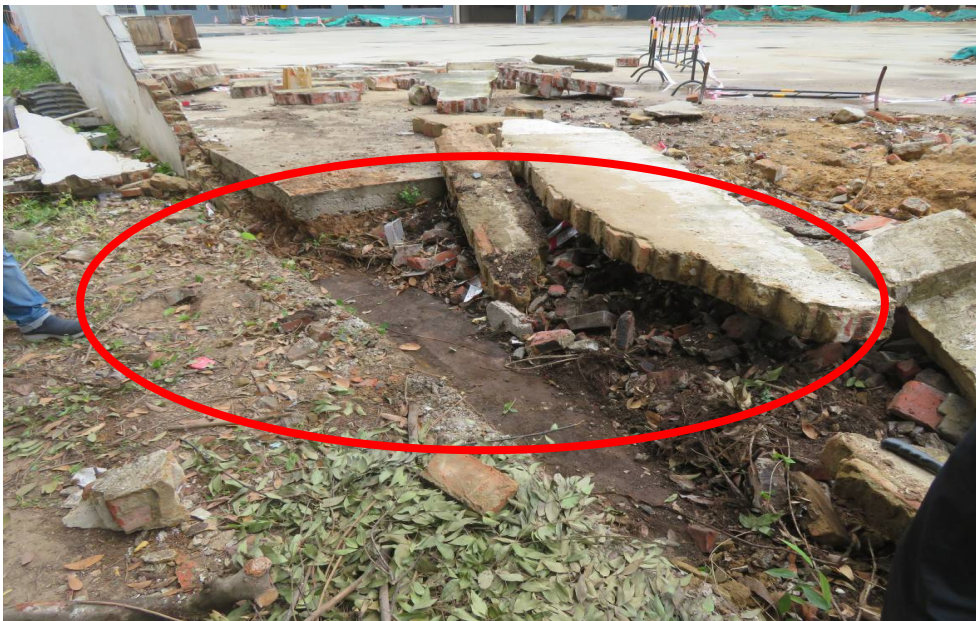
图 3：围墙无独立基础，直接砌筑于厂区原旧水泥地面，底部墙身没有有效埋深
