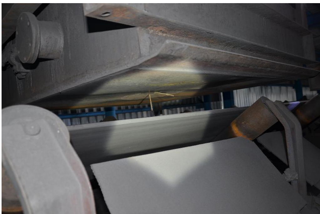
图 6 新 2 皮带除铁器底部摩擦减层痕迹
