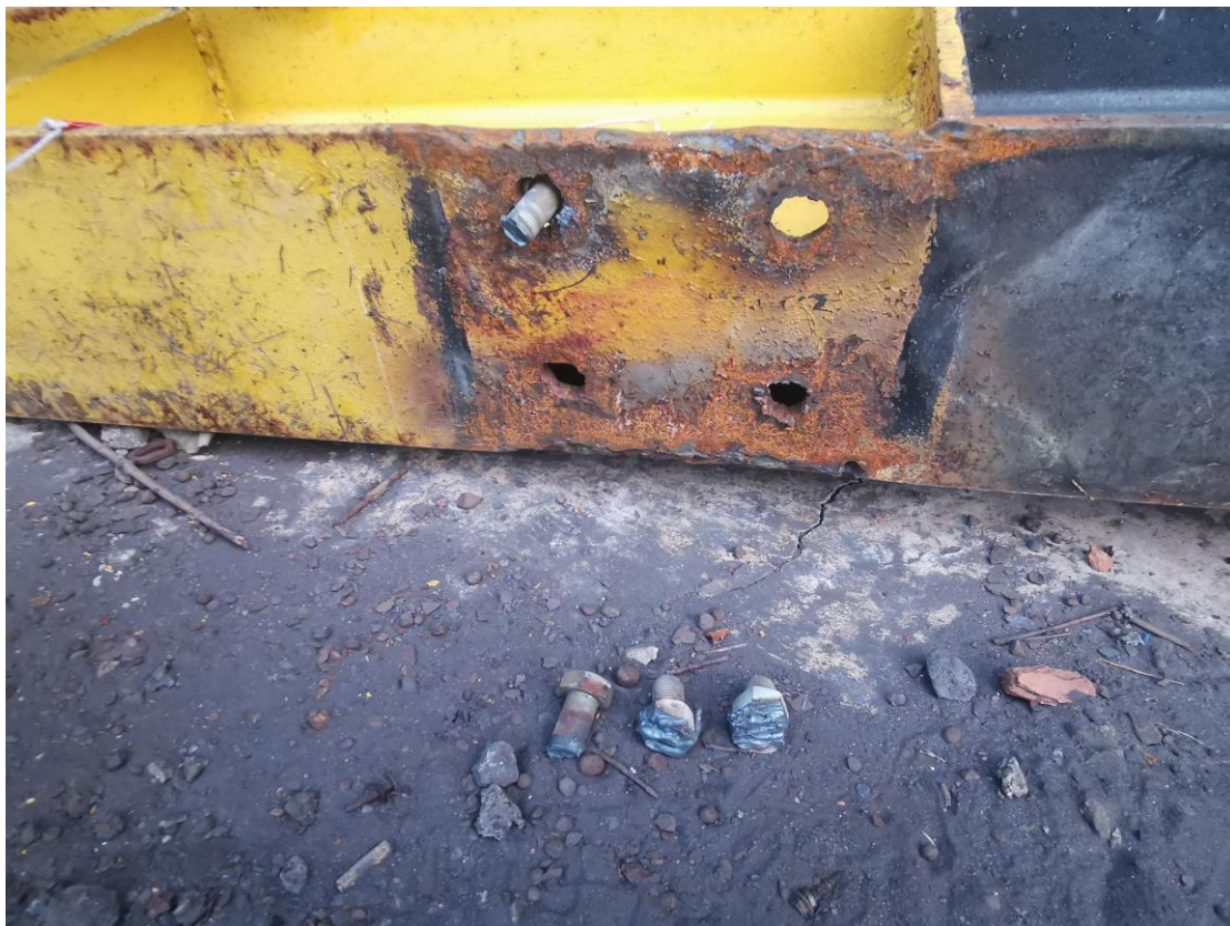
图六 横梁与立柱连接处被切割的固定螺栓
