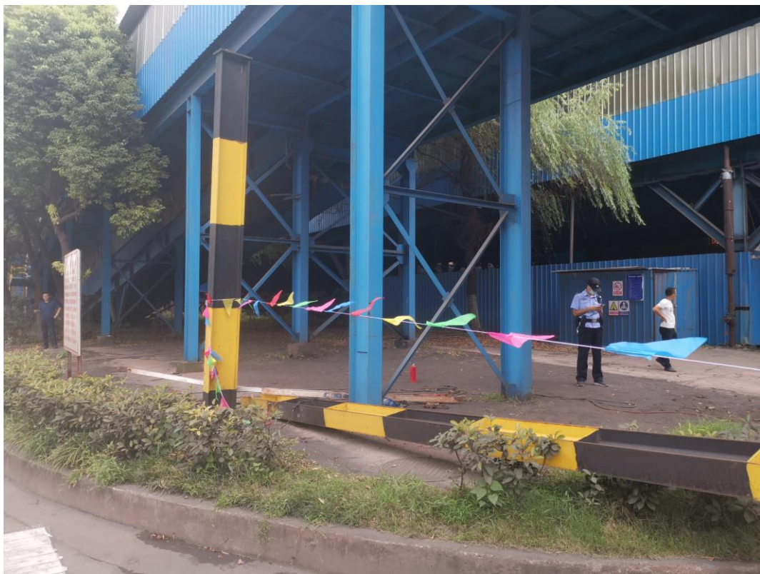
五 事发后的横梁北端坠落至地面
