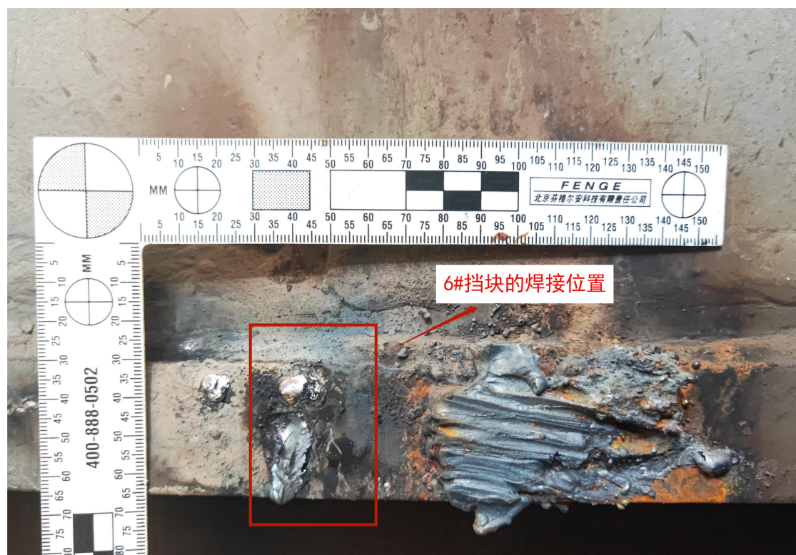
图十一：6#台车挡块在风箱内侧壁上的焊接痕迹
