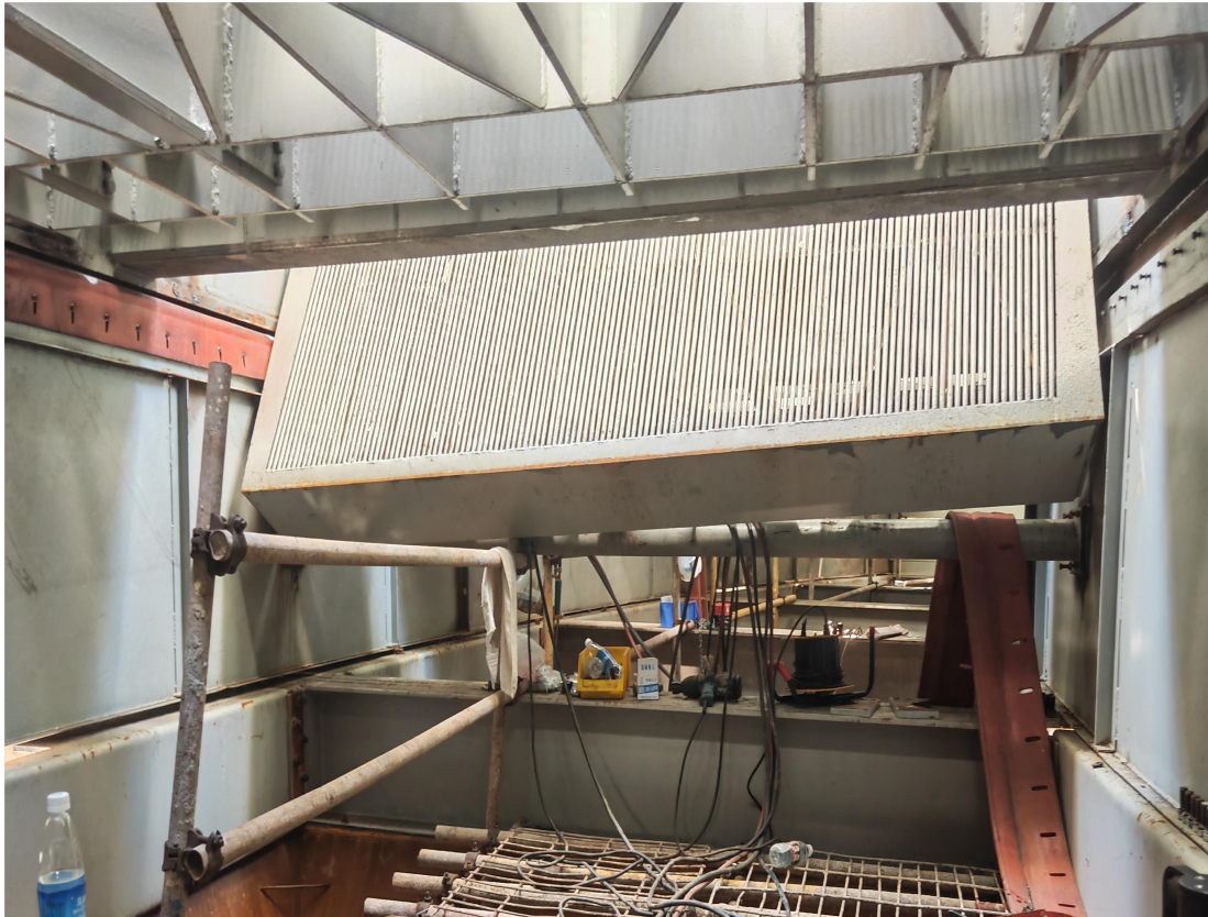
图六：发生事故的 C#烧结机环冷机 6#台车
