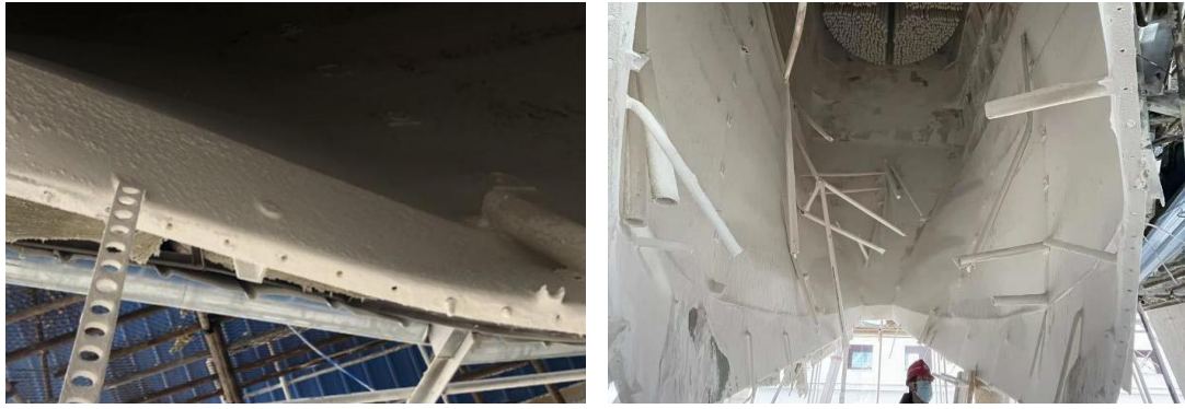
图 16 事故 D 灰斗底部斜槽破坏情况
