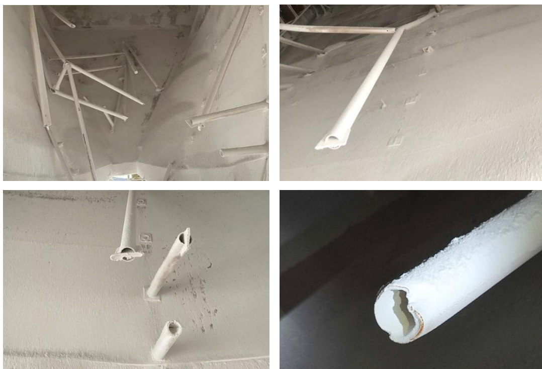
图 15 事故 D 灰斗内部管撑破坏情况
