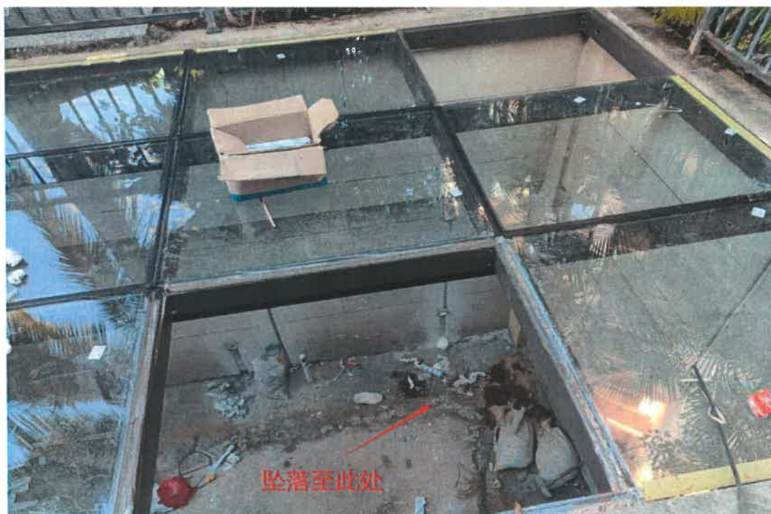
图 1 事故现场照片
