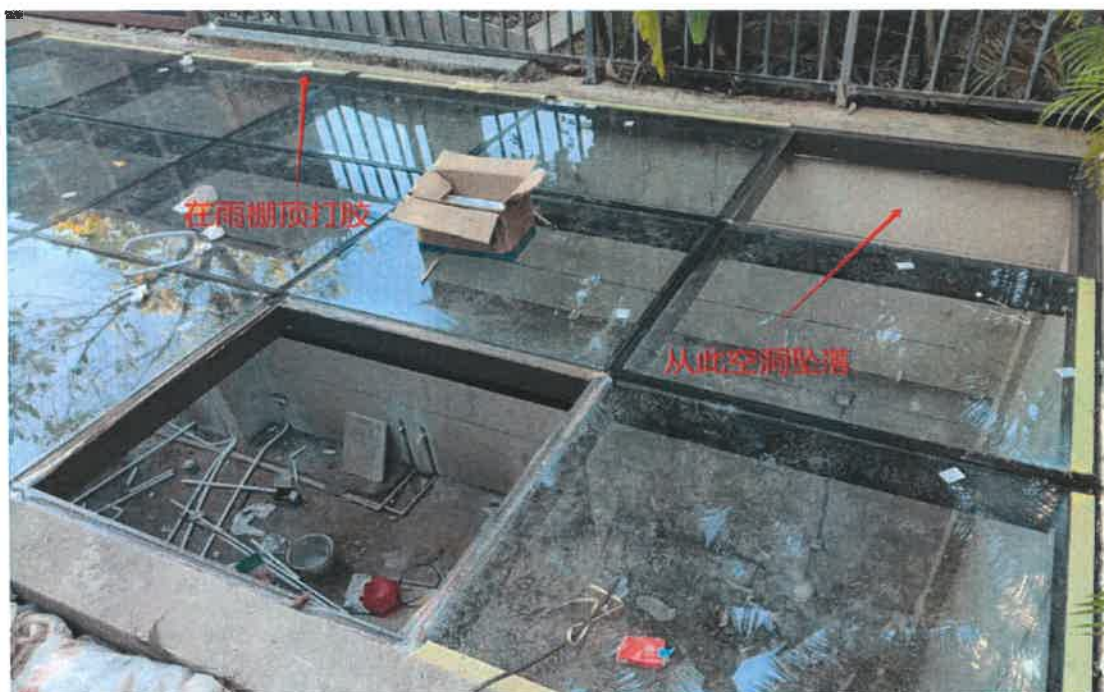
图 2 事故现场照片
