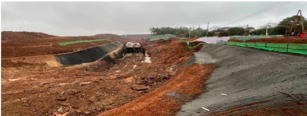
图4 垮塌区域及周边坡顶未见坡顶排水沟
