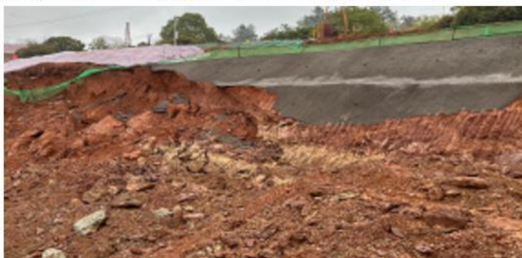
图 2 坍塌区域边坡支护情况现场照片
