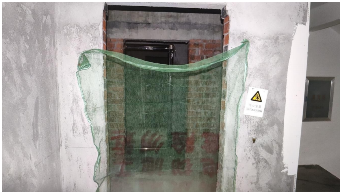
(图 1) 事发当天照片，五楼电梯口临边安全防护情况
