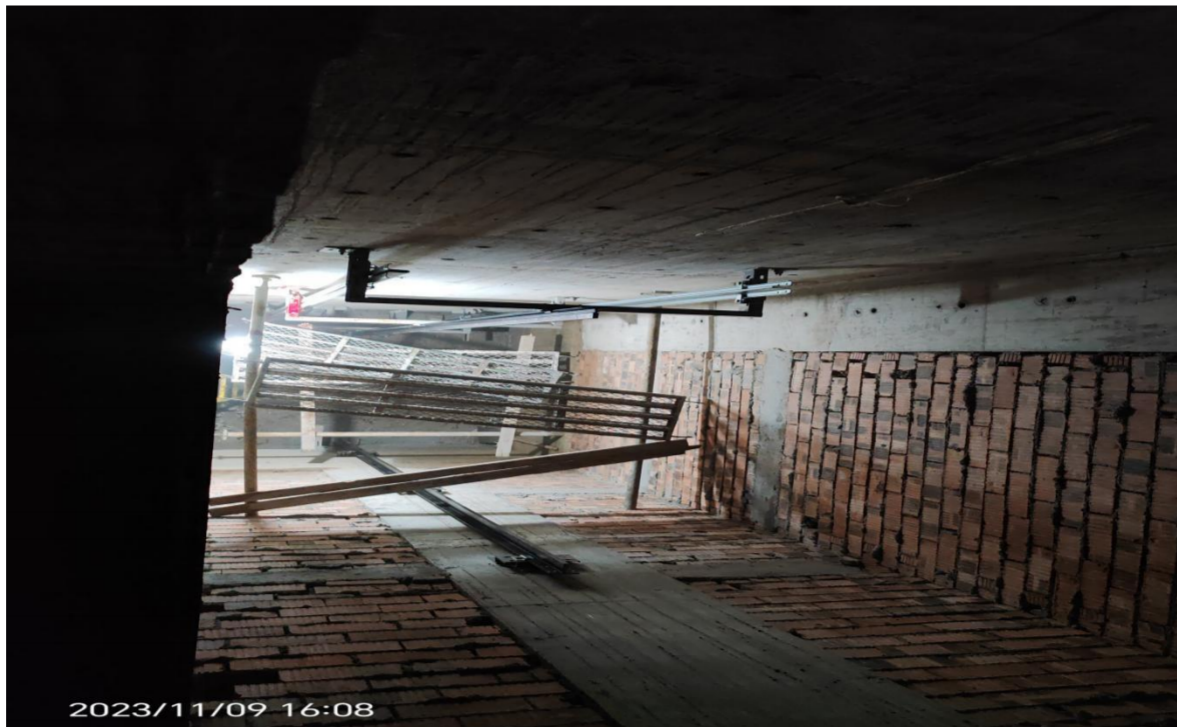
(图 2) 事发当天照片，电梯井基坑坠落点（可见血迹）
