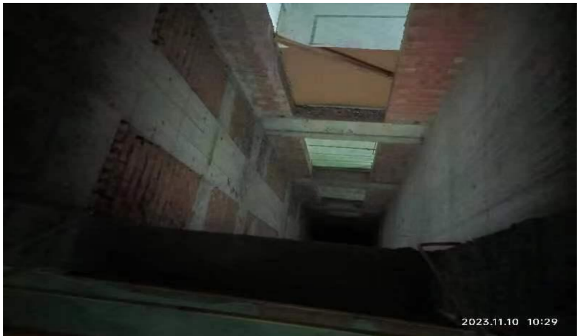
(图 3) 五楼俯视图，电梯井未做水平防护
