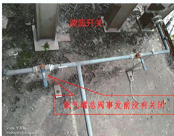
图 10 液氮储罐总阀
