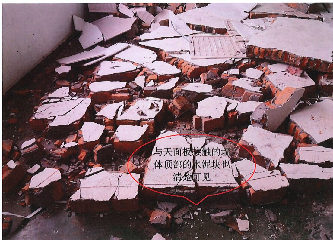
图 7 与天面板接触的墙体顶部的水泥块也清晰可见
