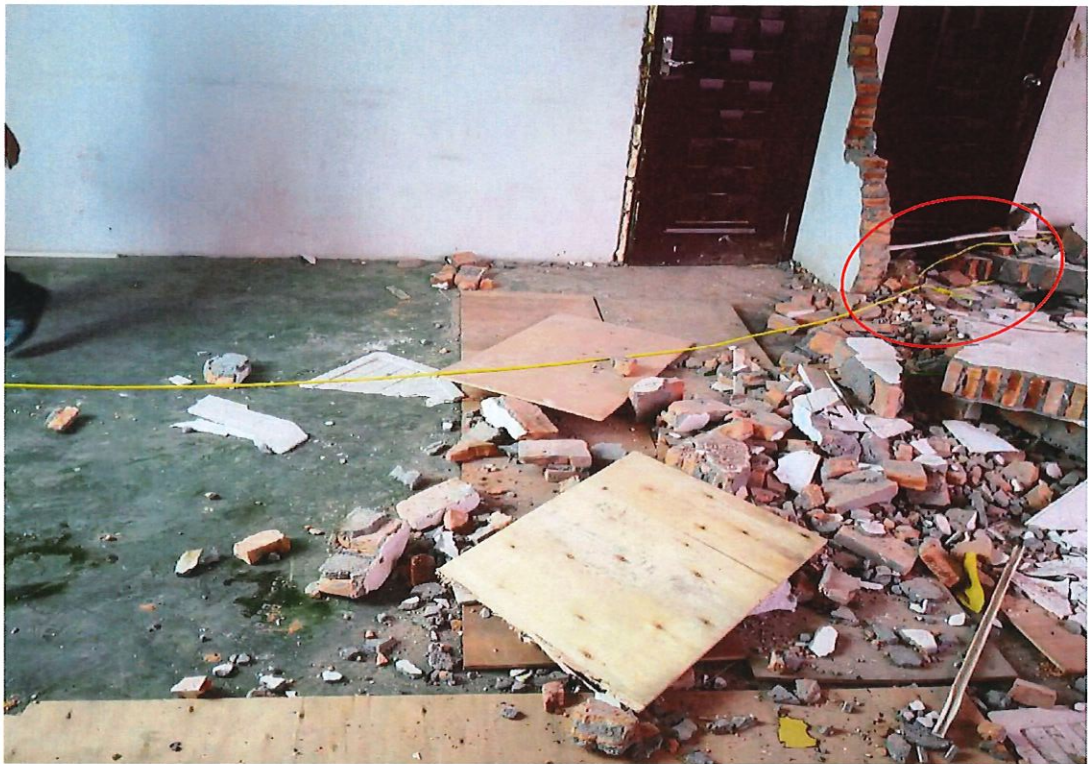
图 11 现场有一条塑胶绳有一端连接墙体
