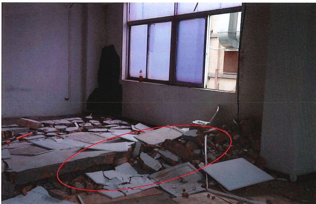
图 8 倒塌的墙体根部有一条长的红砖碎块堆
