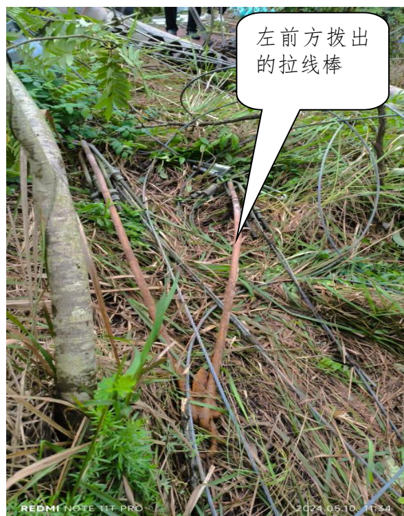
图 7 左前方拉线棒被拔出位置
