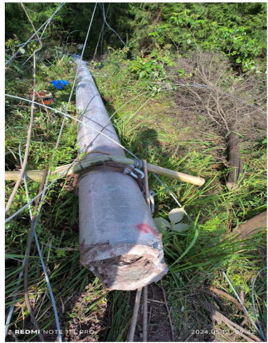
图 3 坍塌的 3#新电杆
