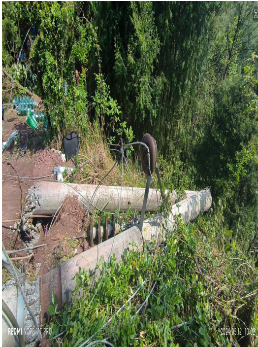
图 2 坍塌的 3#原电杆
