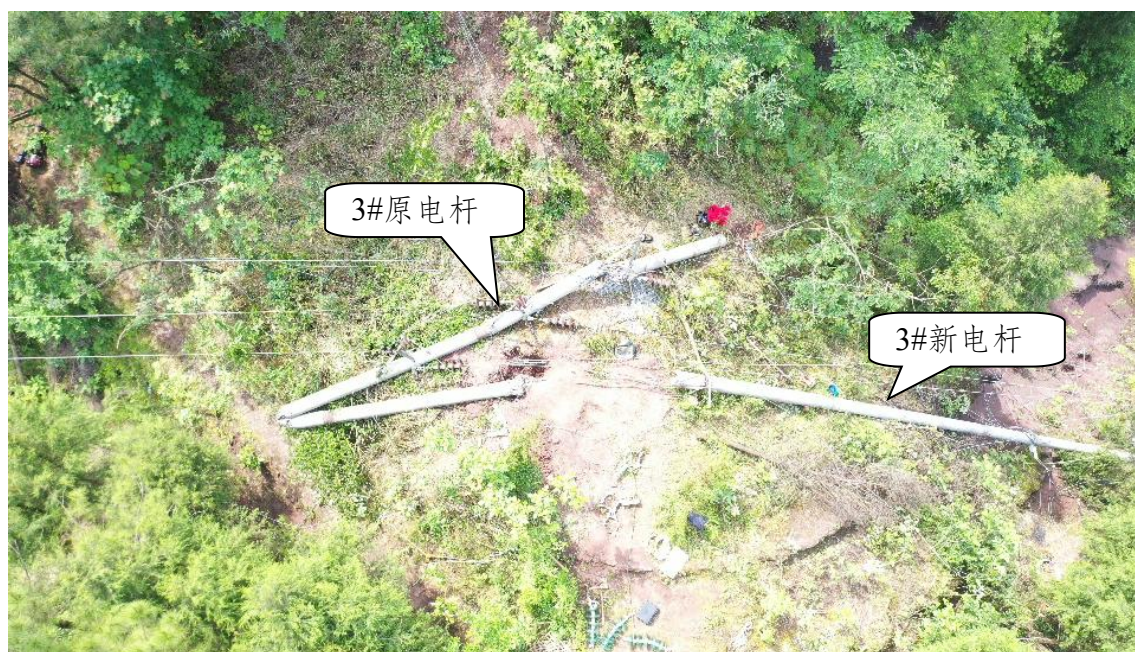
图 1 事故现场航拍图
