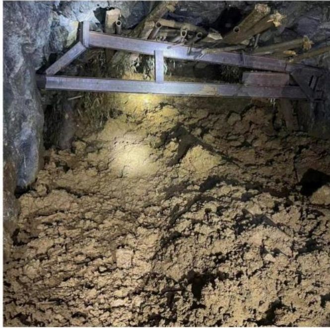
图6 事故现场 1#穿照片（2023 年 4 月 23 日 10 时调查组摄）
