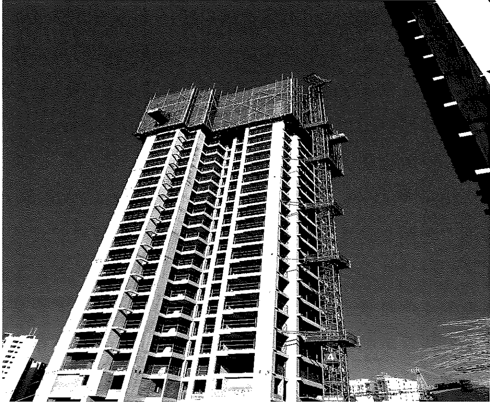
事故塔吊全貌
