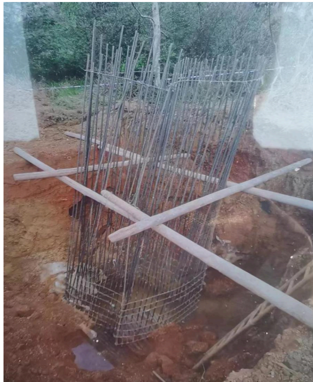
图4事故现场坍塌后实景图
