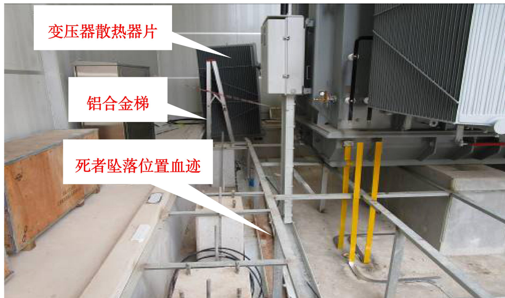
图 2：3# 变压器室内情况
