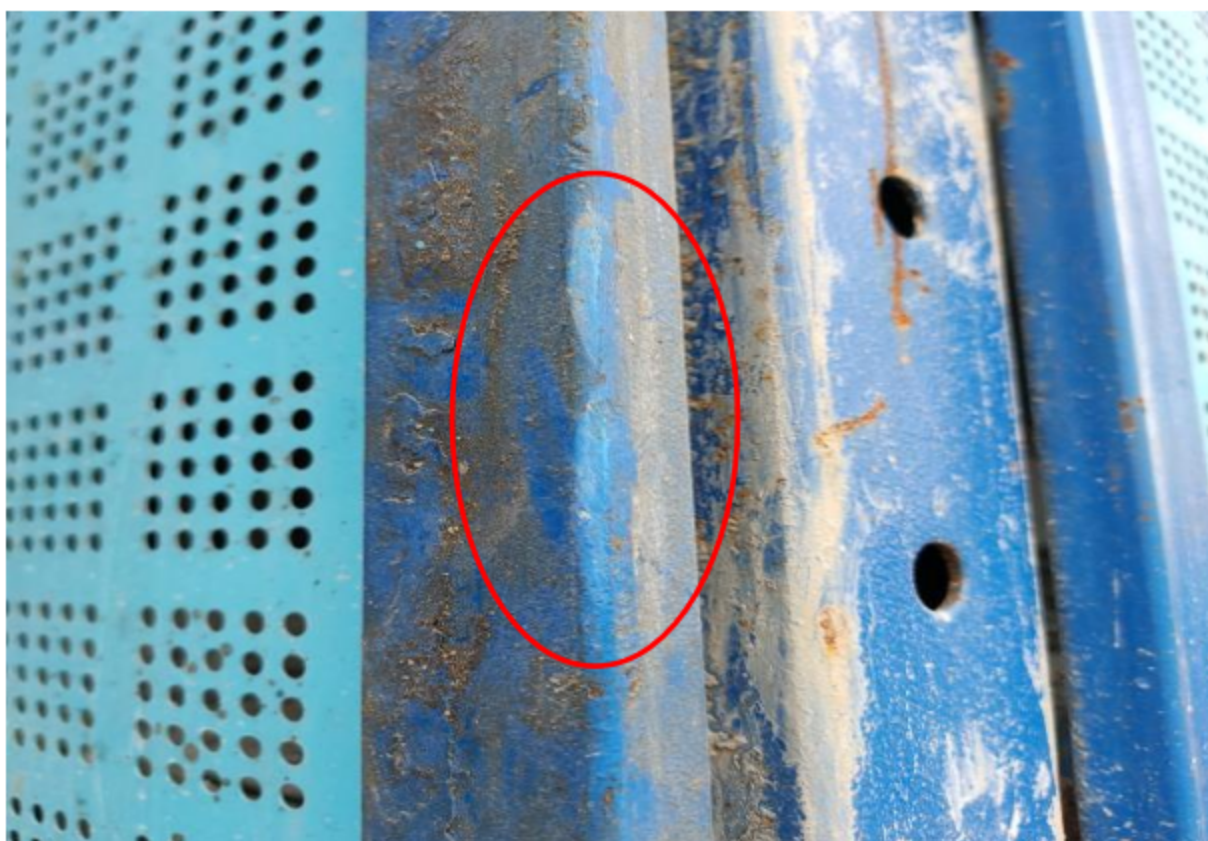
图 6、7 28 层卸料料台右侧爬架防护网立柱有划痕
