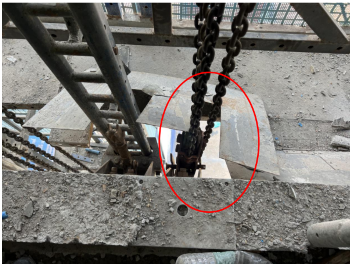
图 5 29 层西侧爬架料台导座处洞口可直通爬架外墙， 洞口处的防护翻板铺设不严密
