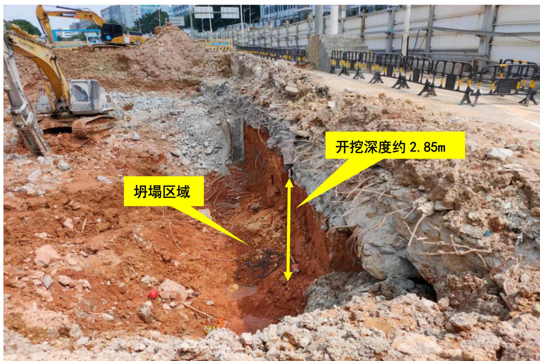
图 4：事故现场近照
