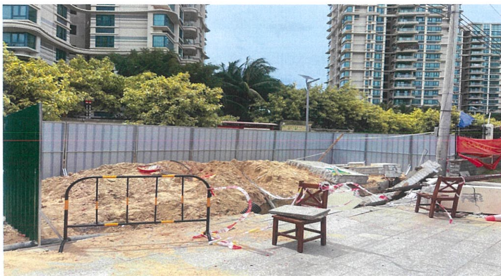
图 1 事故现场照片
