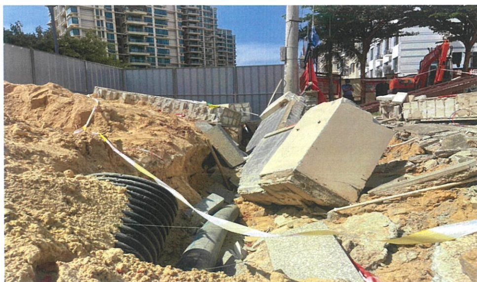
图 2 事故现场照片
