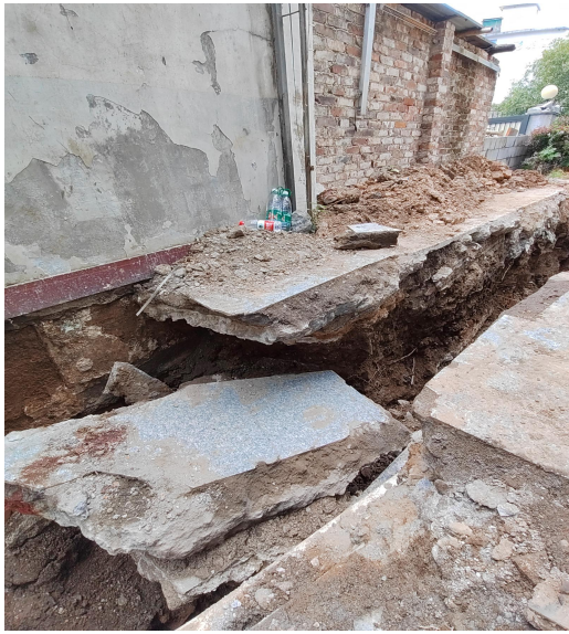
图 3 垮塌混凝土块
