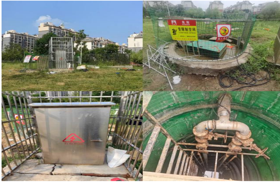
图 4 事故现场照片
