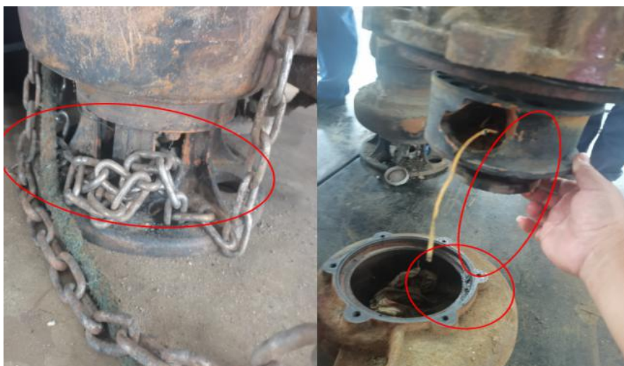
图 6-1 1 号泵底部链条和布料造成堵转
