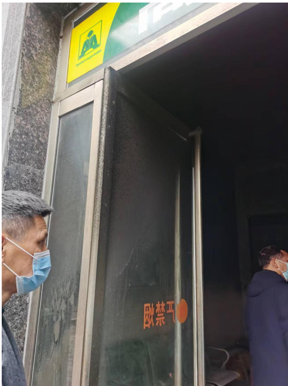
附图四 高压氧舱房间入门烧损情况
