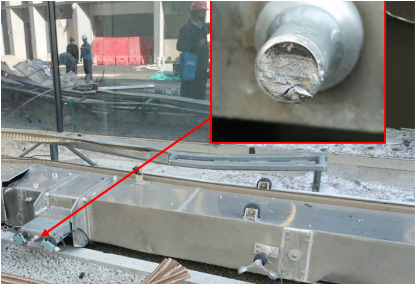
图11：承重螺杆断口
