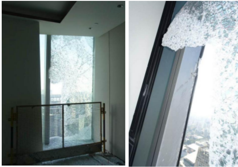
图10：55楼楼内玻璃破碎
