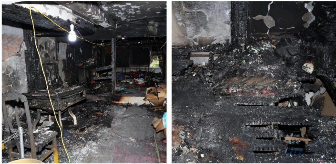
图5 店面夹层中部区域现场痕迹
