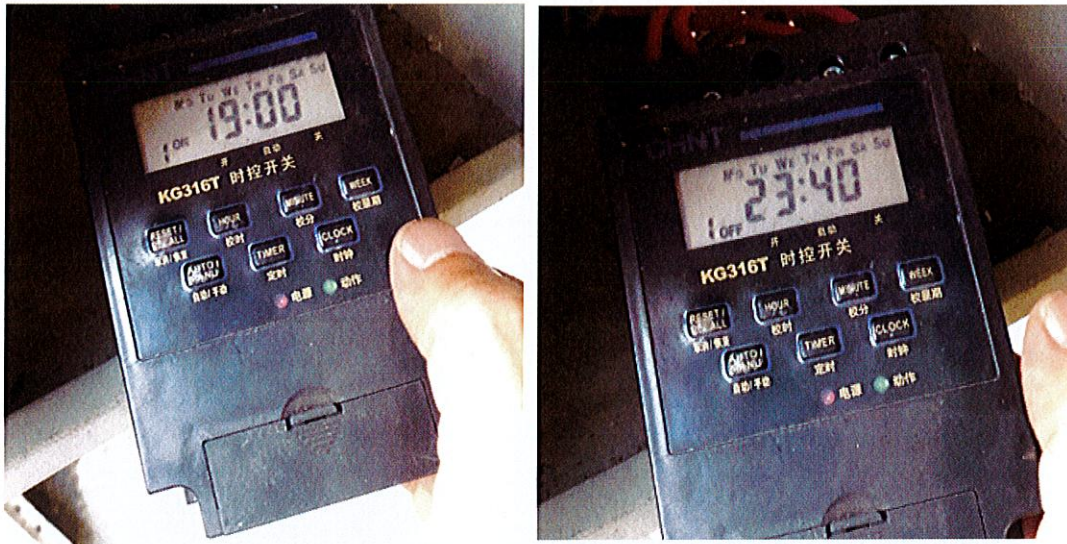
图 6 投射照明灯时控开关设置情况
