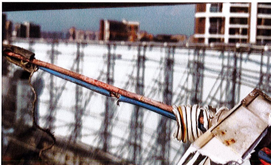
图 8 事故发生点广告灯电源线破损现象
