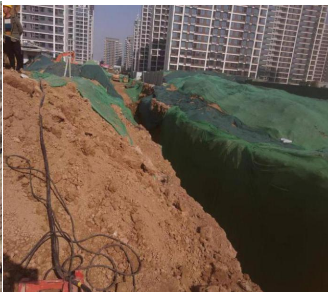
图 5 事故现场弃土堆于沟槽两侧
