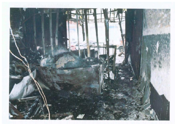
图6：事故现场图片（1.2.3）
