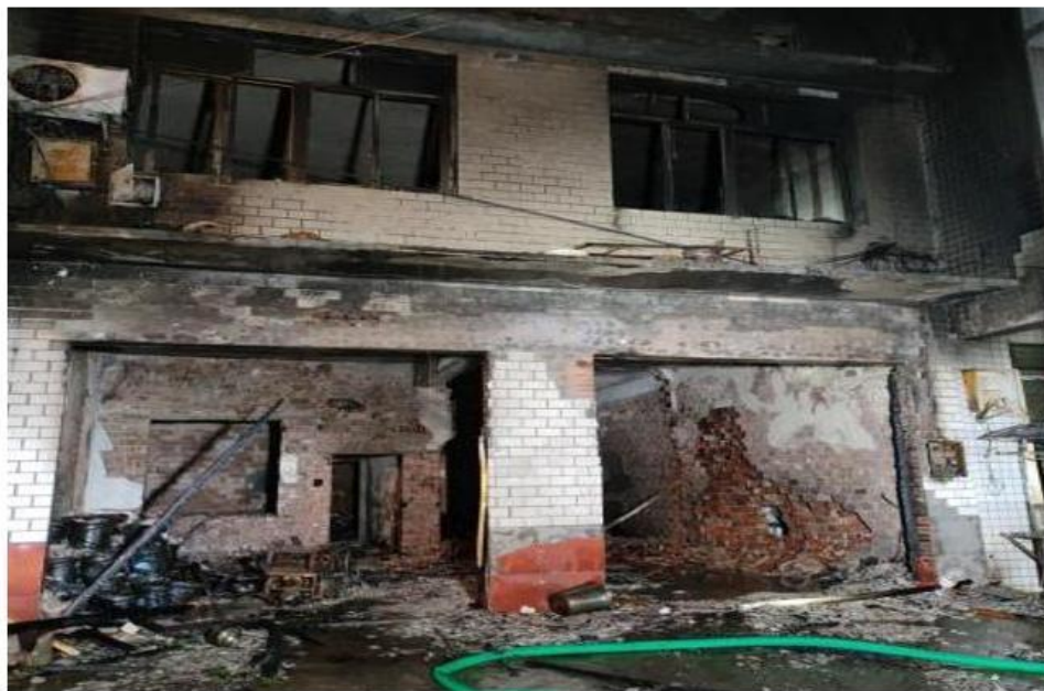
图 1 事故现场照片
