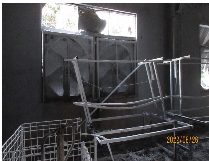
▲图 4 排气扇位置
