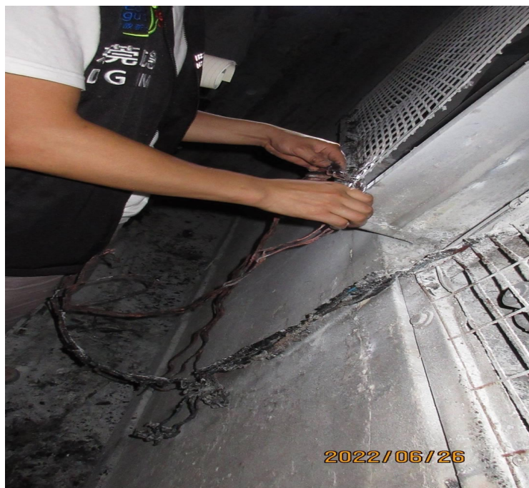
▲图 5 勘查电线短路现场
