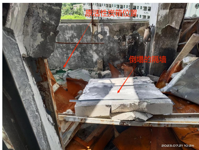
图 3 事故车间倒塌的隔墙
