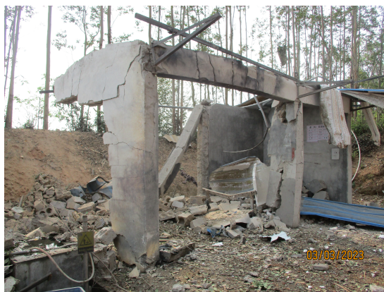
图为华源厂“3·3”爆炸事故现场
