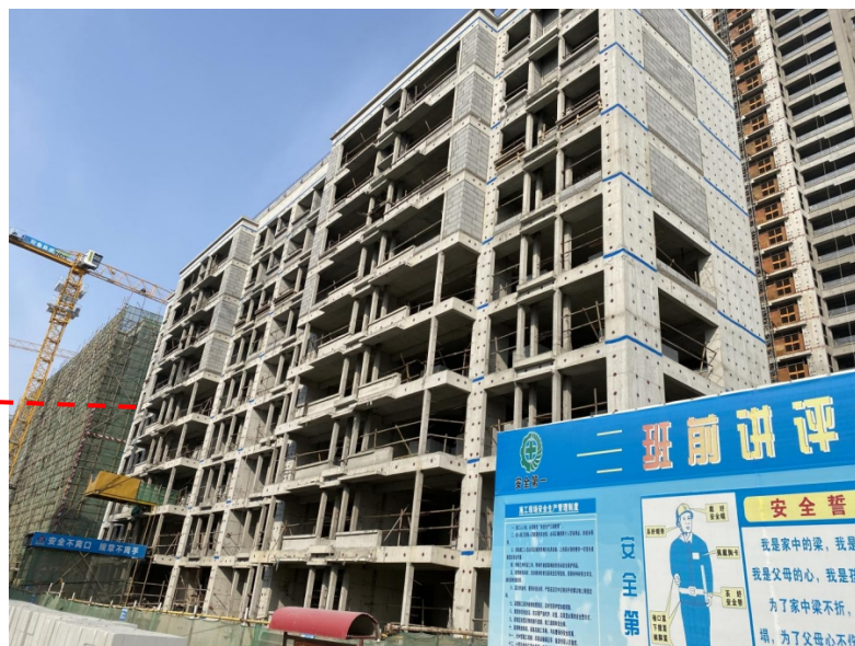
图2 发生事故的5号楼
