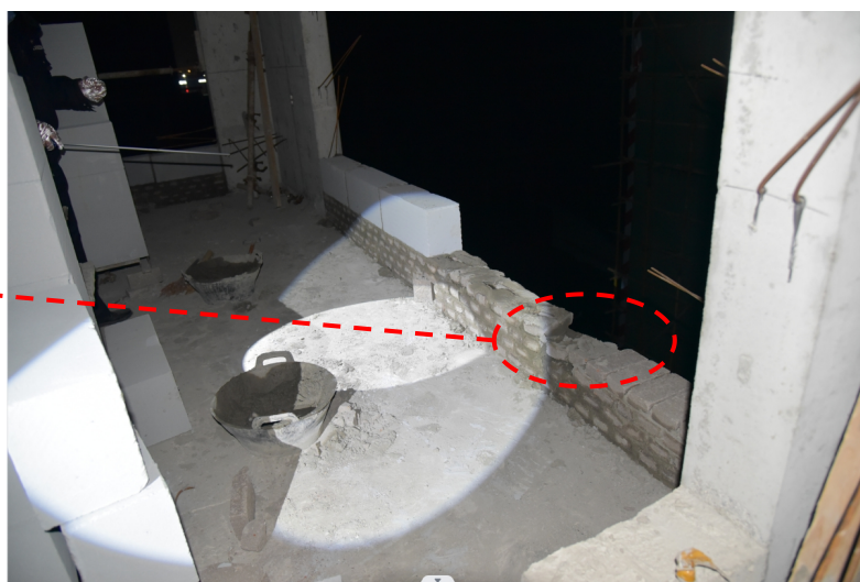
图3 发生事故的5号楼5层现场
