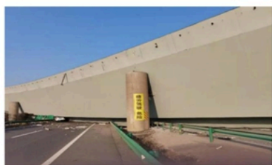
图 10 梁体斜靠独柱墩
