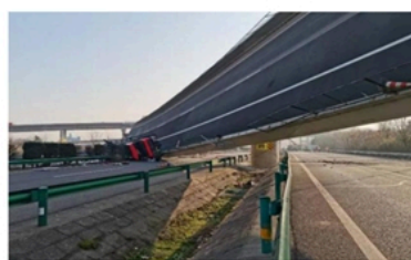
图 11 桥面沥青混凝土面基本完好
