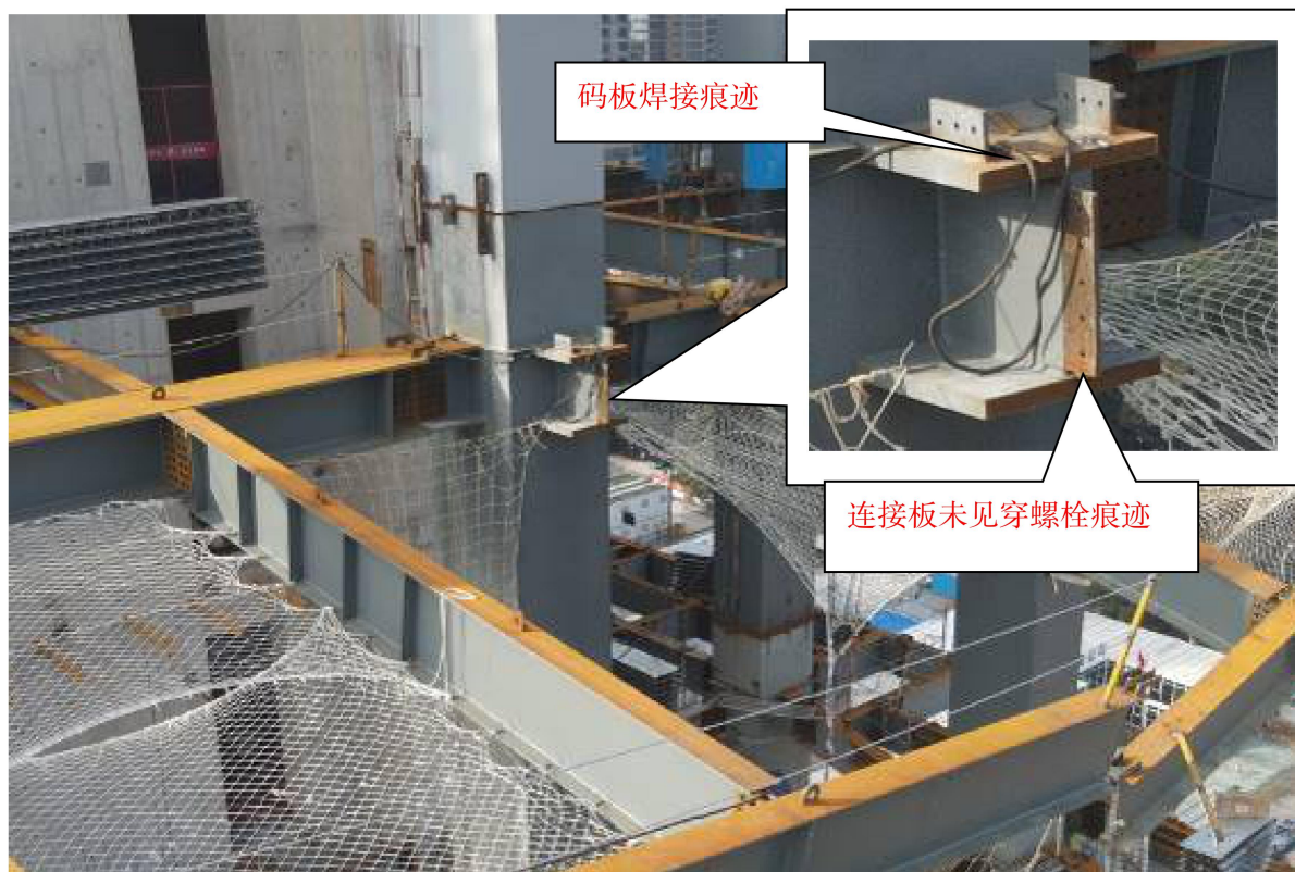
图 4: 坠落钢梁与钢柱连接节点
