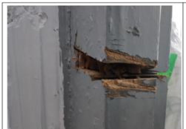
图 2 现场木门框切割痕迹
