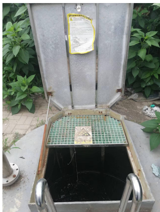
（事发泵站及安全操作规程）
